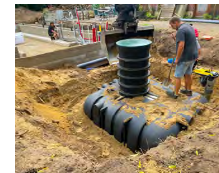
Waterbuffering door middel van opslagtank
