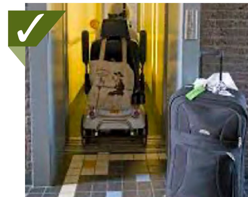
✓ Degelijke lift met stootprofielen. Onderdelen voor onderhoud uit voorraad leverbaar.
