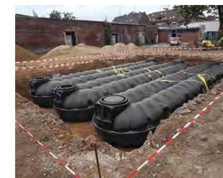
Waterbuffering door middel van meerdere opslagtanken
